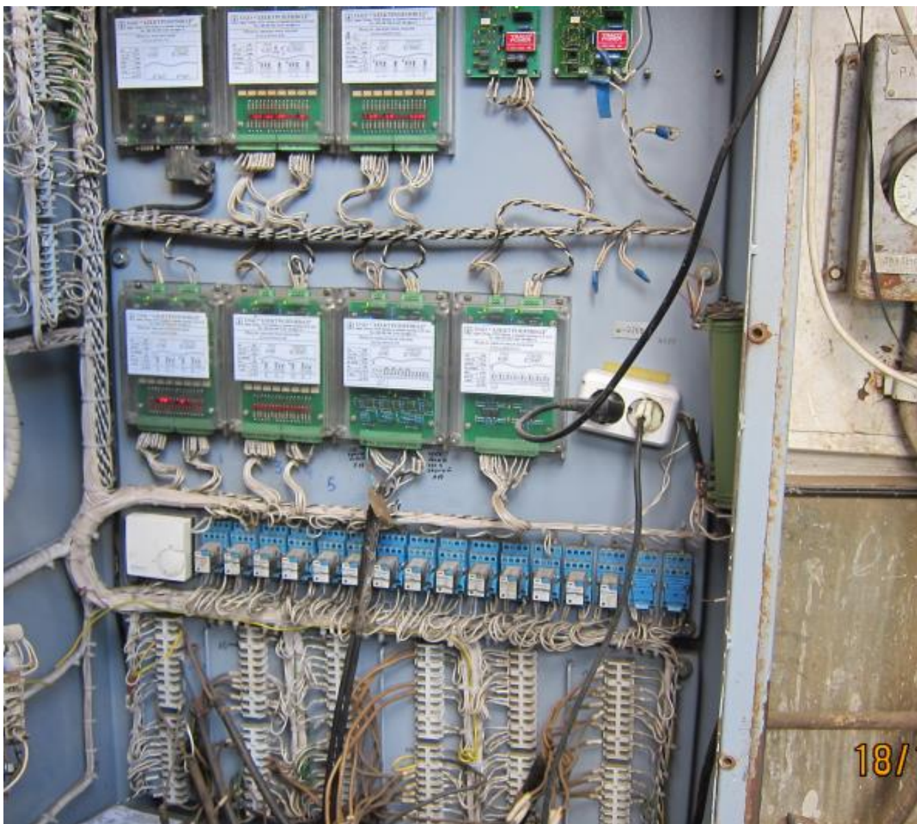
Рисунок 29. Ящик управления электромагнитным тормозом ТЭП-45. Подключение РПД ИМ2440М.
