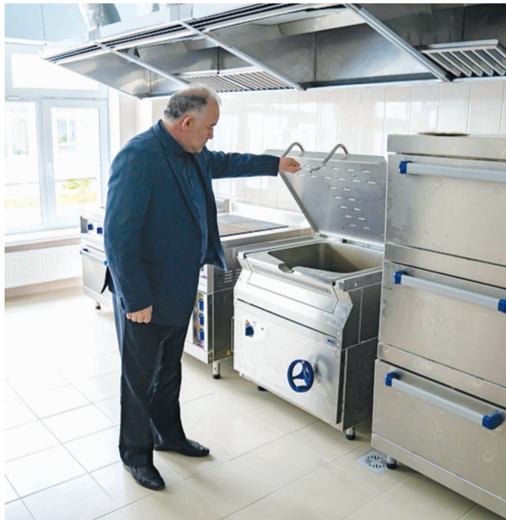
В школе № 21 Магомед Османов осмотрел проведённый ремонт вентиляционной системы и помещения пищеблока. Фото Евгения ГРОХА
