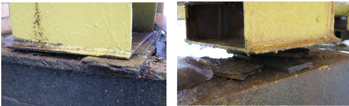
Рисунок 4.1 – Характерные дефекты опор трубопроводов ГРС: неполное прилегание опоры (а) и отсутствие контакта между опорой и основанием (б)
